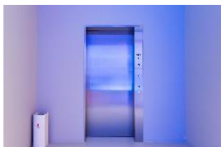
館内移動エレベーター
